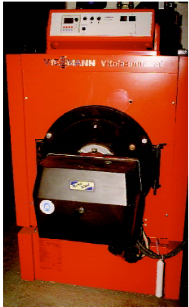
Abb. 5 Weber-Isis-Universal-Aktivator: Montage an der Heizung im Keller (Ölleitung)
